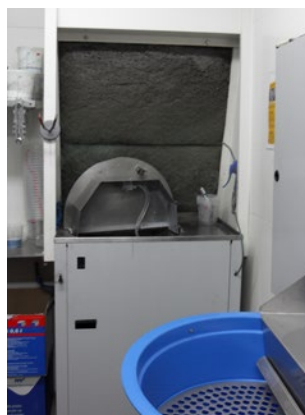
Photo 5 Captage enveloppant au niveau d'une machine de lavage des pistolets
